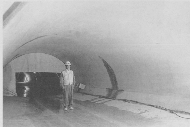
高瀬下水処理場につながる幹線管渠。内径5メートルは県内最大です
