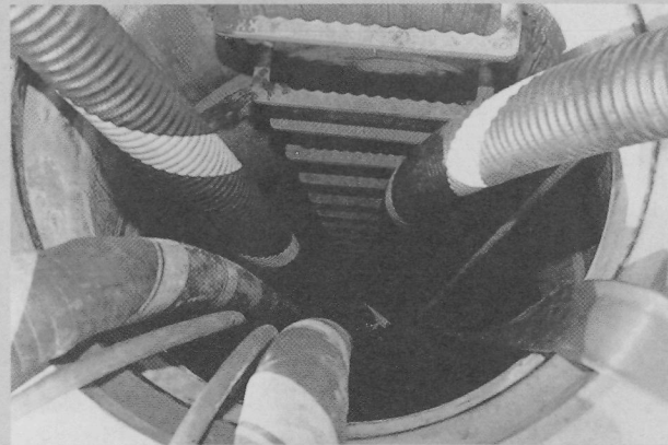
雨水放流管のマンホールから海水をくみ上げます
