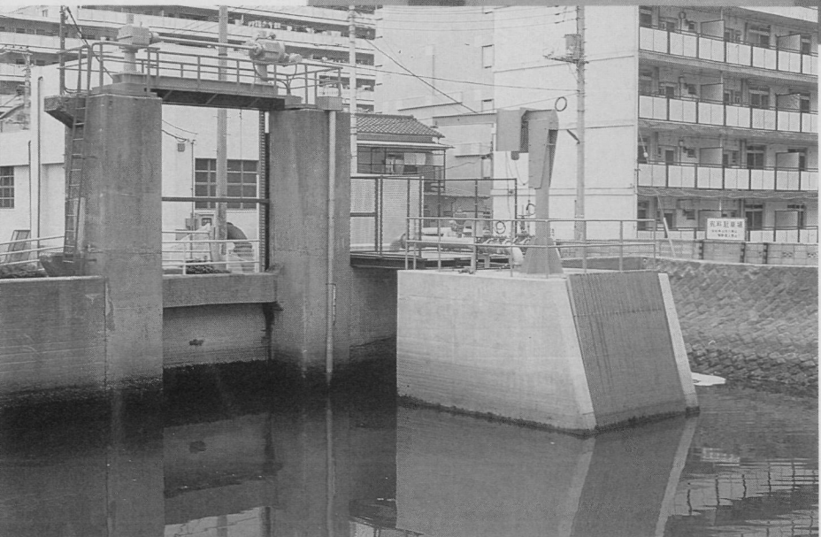
日の出水路に設置された山谷水門取水ポンプ。システムが稼働すると、このポンプから毎分5トンの海水が取り込まれます
