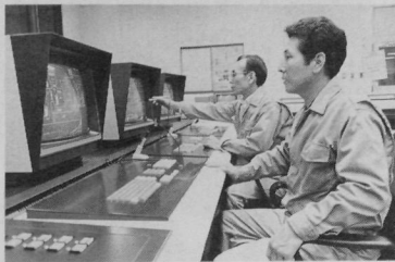
水害から市民を守るため24時間 市内9か所の水門をコントロールする市の排水施設管理事務所
