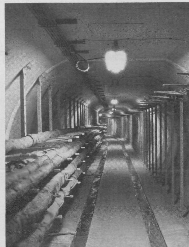
NTT船橋支店が管理する地下トンネルのケーブル。耐火性の布で覆われている
