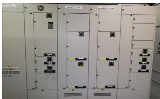
コントロールセンター盤（更新前）
