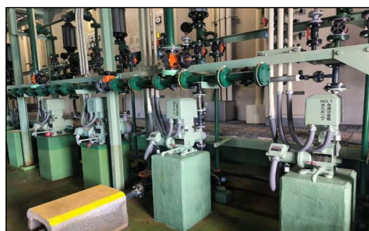
次亜塩注入ポンプ（更新後）
