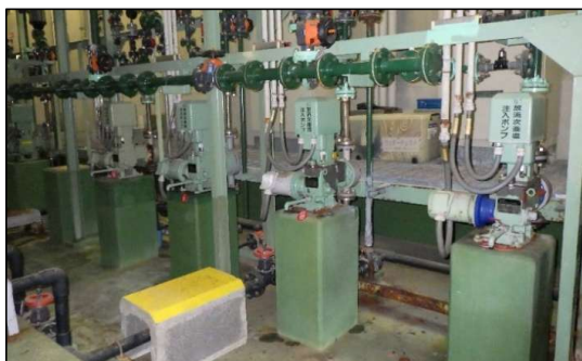
次亜塩注入ポンプ（更新前）
