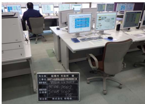
中央監視Webクライアント
