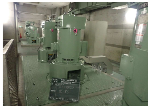
汚水ポンプ電動機
