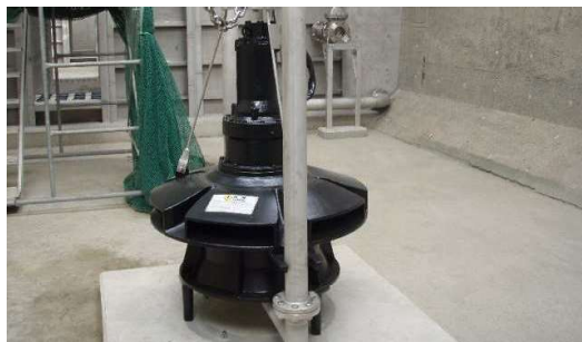
水中攪拌機 (参考 平成14年設置当時)
