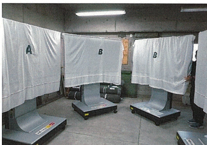
作業前 表示盤
