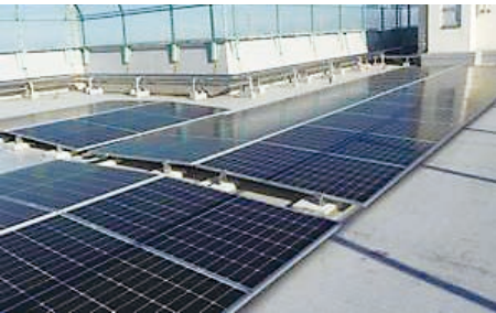
▲丸山小に設置された太陽光パネル
