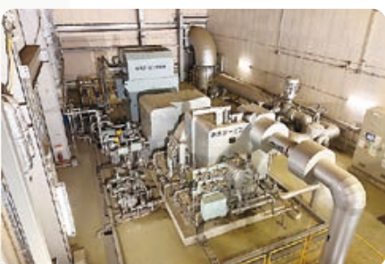
▲北部清掃工場の廃棄物発電設備
