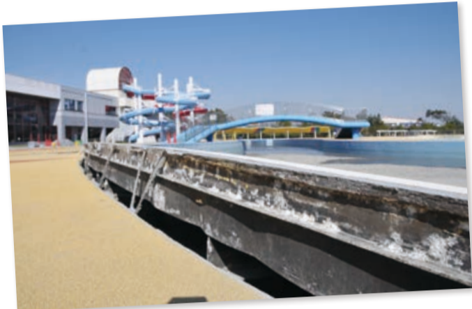
▲ふなばし三番瀬海浜公園では大きな被害があり、プールは使用できなくなりました
