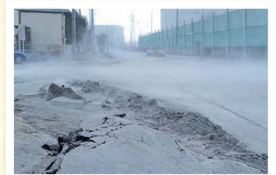
⑨船橋市でも液状化によって道路に亀裂が入るなど、多くの被害が出ました(写真は潮見町)
