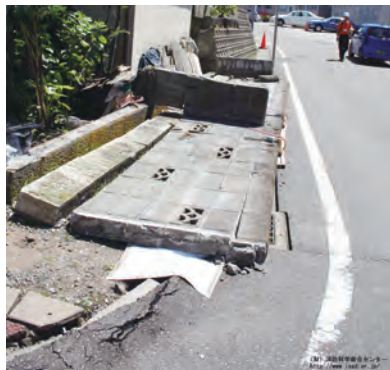
▲平成19年新潟県中越地震による倒壊(出典：災害写真データベース)
