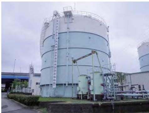
▲燃料となる消化ガスが貯められる消化ガスホルダー
