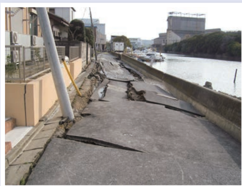
▲東日本大震災では市内南部を中心に液状化の被害が発生
