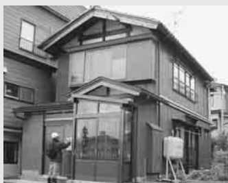
▲新潟県中越地震後、建築物危険度で「要注意」の判定を受けた木造住宅
