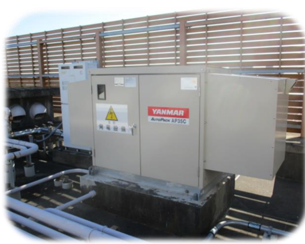
宮本公民館にある非常用電源装置
