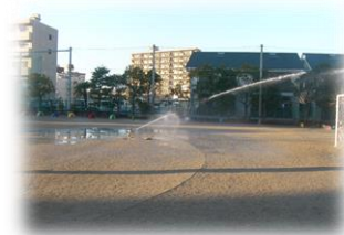
校庭散水栓設備
