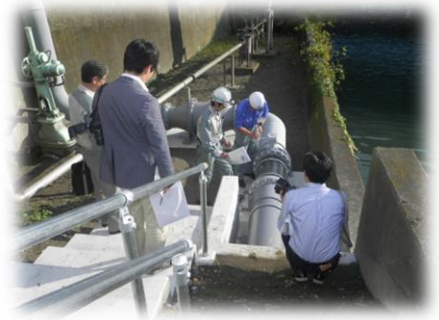
西浦下水処理場の小水力発電装置
