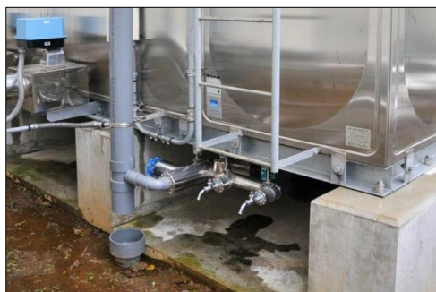
▲ 受水槽に設置した給水栓
