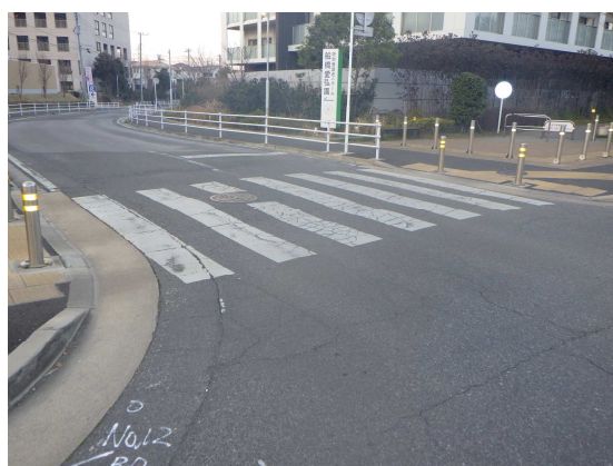
図 1-7 道路の舗装の劣化事例
