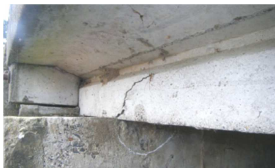
(B) 橋梁コンクリート主桁のひび割れ
