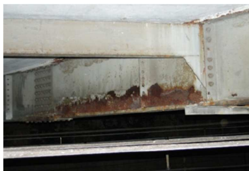
(A) 橋梁主桁部の劣化・腐食
