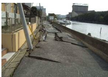
液状化による電柱の傾斜
