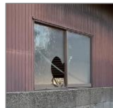
窓が割れた管理不全空家
