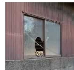
窓が割れた管理不全空家
