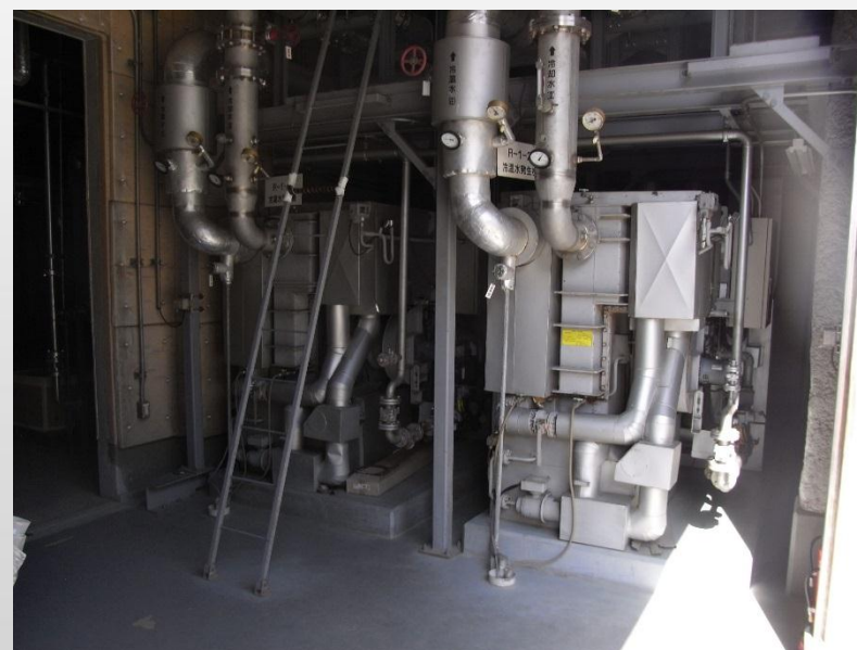
• 2004年更新された吸収式冷温水発生機（B館）
