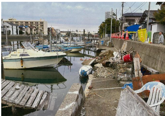
護岸崩落時の状況 (令和4年11月)
