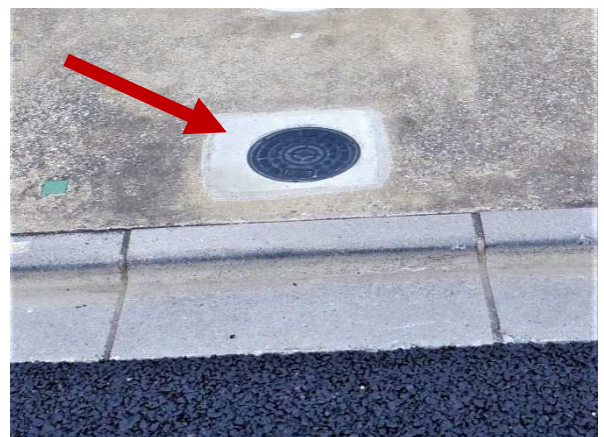
公共汚水ます
