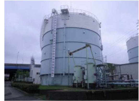
消化ガス※タンク
