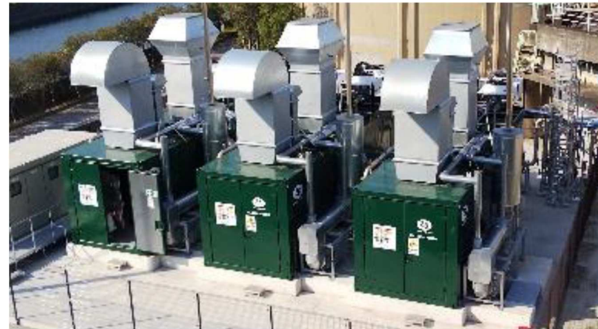
ガスエンジン発電機 (消化ガスを用いて発電)
