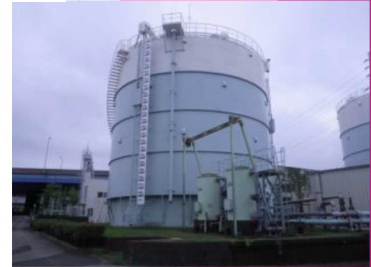
消化ガス※タンク
