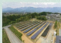
リユース品を使用した発電所
