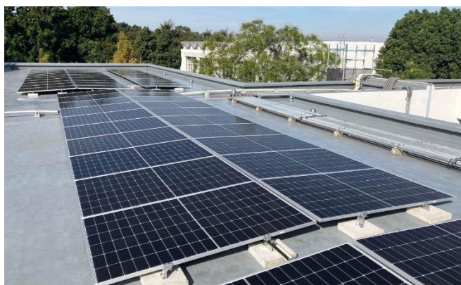
太陽光発電設備(例)
