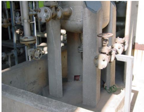
写真1 タンクの支柱の耐火の例
