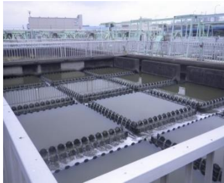
下水処理 (汚泥発生)
