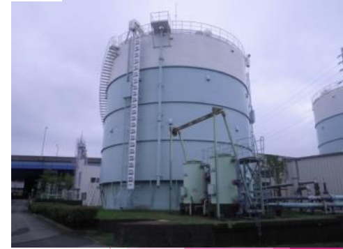
消化ガス※タンク
