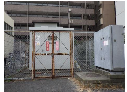
右側のような保安設備(UGS) が付帯していることも多い
