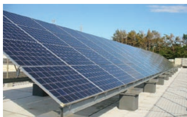
西海神小学校に設置されている太陽光パネル
