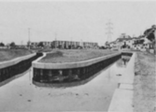
長津川と上長津川とに分かれる北本町付近、ここも総合治水対策事業ですっかりきれいに整備された
