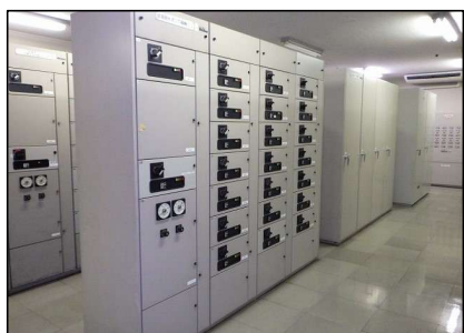
動力設備（コントロールセンタ）
