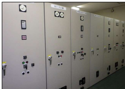
受変電設備（引込盤）
