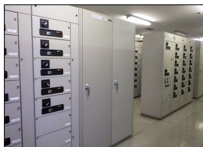
監視制御設備（補助継電器盤）
