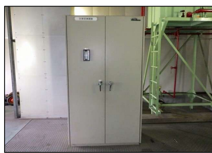
監視制御設備（計装変換器盤）
