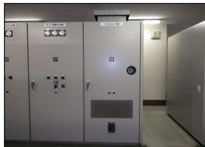
受変電設備（変圧器盤）
