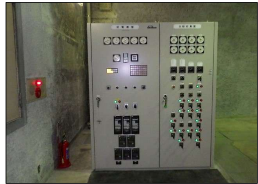
発電機盤・自動始動盤
