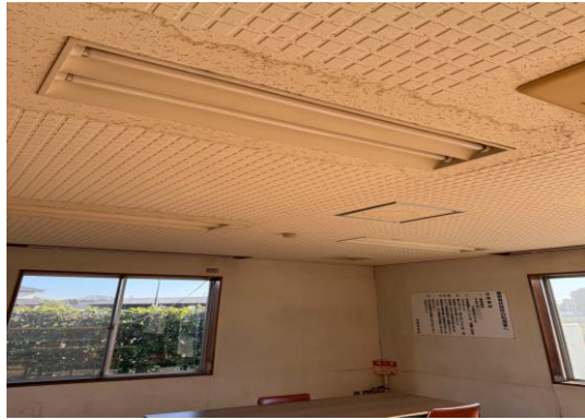
老朽化の進展（写真：墓参者休憩所）
