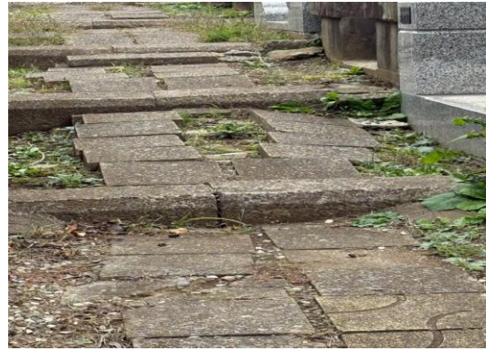
段差が生じている通路
