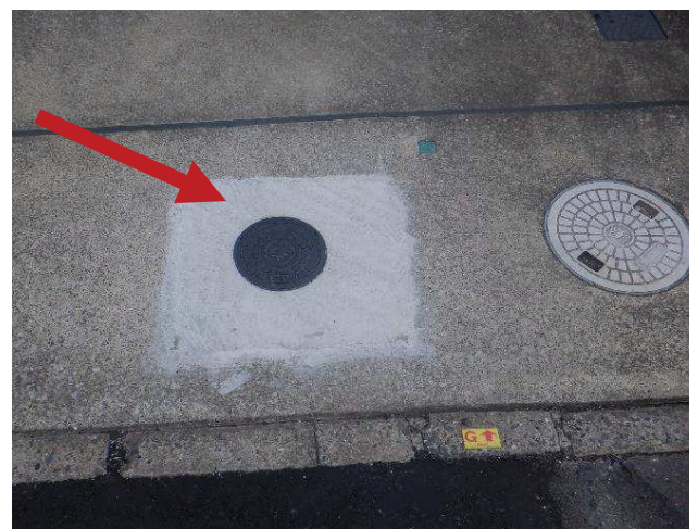
公共汚水ます
