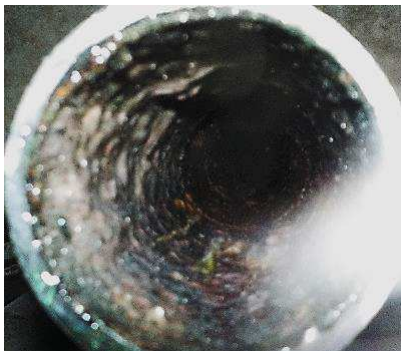
施工前 錆コブや汚れで狭くなっている管内
