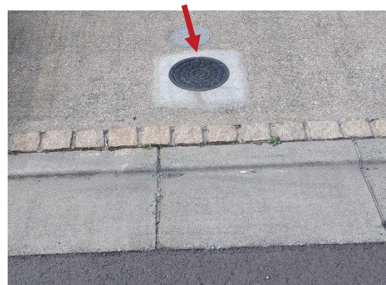
公共汚水ます
