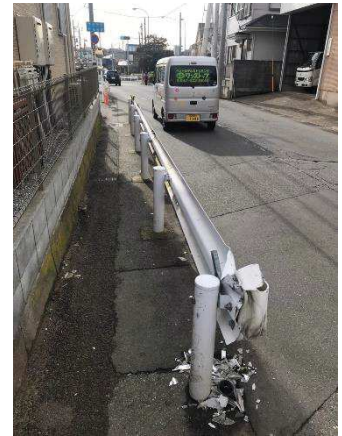
ガードレールの破損
