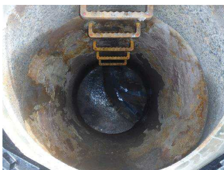
老朽化した人孔内部
