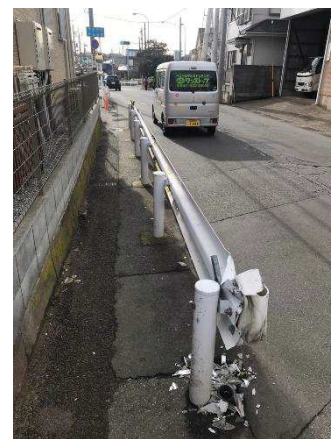
ガードレールの破損
