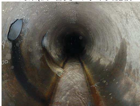
老朽化した管内部
