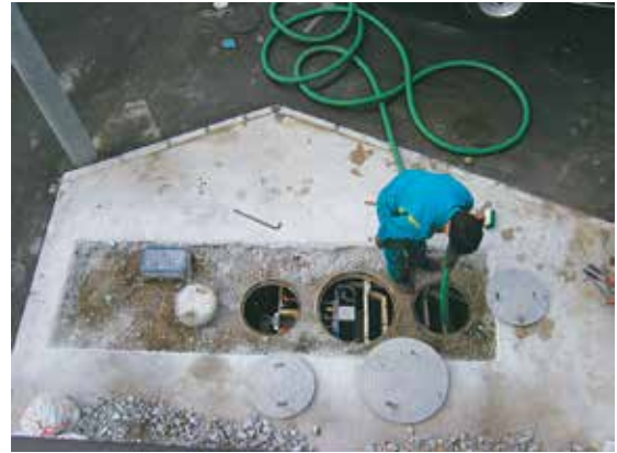
② 汚泥を引抜き消毒します。
