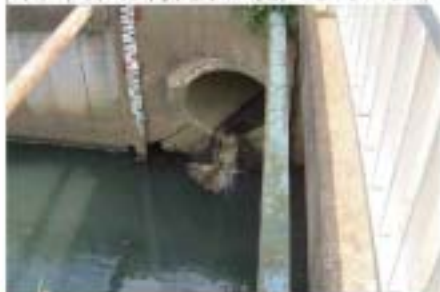
木戸川には汚濁水が流入しています
