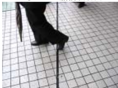
①駅前広場の舗装に大きく溝が入っているところがあり引っかけやすい
