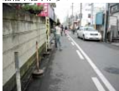
⑫ 住宅地内道路はかまぼこ型歩道で横断勾配がきつく、民地側の設置物も多い
