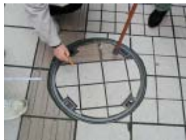
⑥マンホールのふたの上の誘導用ブロックの方向がずれている
