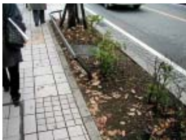
⑦本町通り以南の駅前通りは景観重視のタイル舗装、植栽の柵が壊れている
