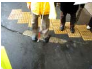
⑤駅前通りの歩道のすりつけは、部分的に高さ 0cm と 2cm が組み合わせてある
