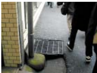
⑤排水溝のグレーチングの目地が大きくて杖や車いすの前輪が引っかかりやすい
