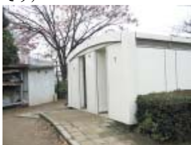
⑪天沼弁天池公園のトイレは車いす対応になっていない
