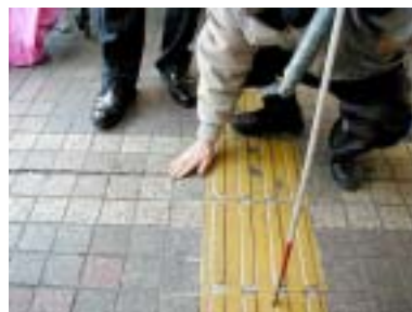
③ 商店街の小型タイルの目地が大きいところがある
