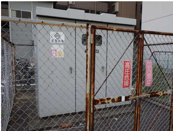
キュービクル式高圧受電設備
