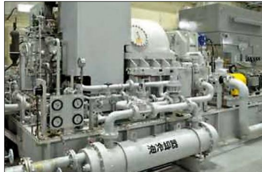
▲ 南部清掃工場の蒸気タービン発電機
