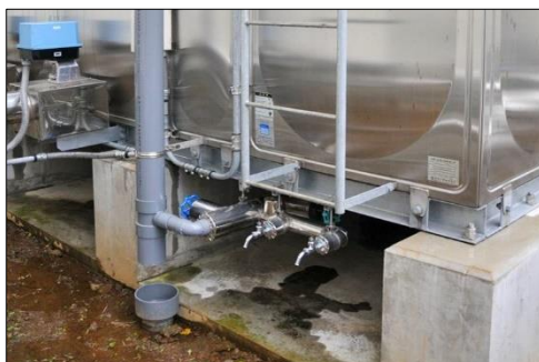
▲ 受水槽に設置した給水栓
